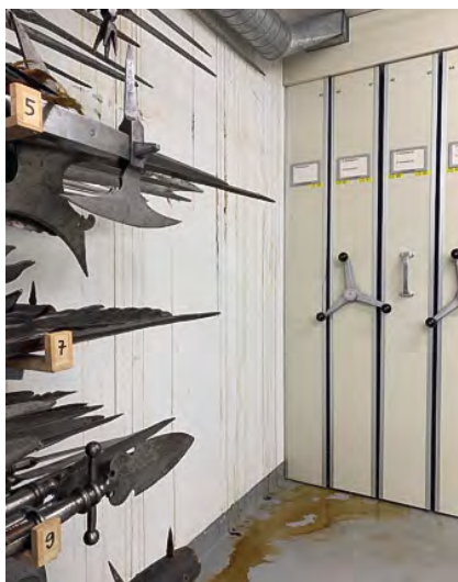
Wasser drang durch die Mauern in ein Depot des Museums Luzern ein.
